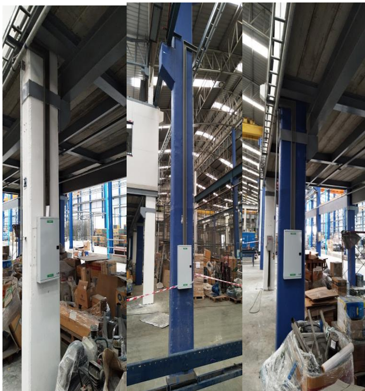
งานติดตั้งระบบไฟฟ้าเครื่องจักรโรงงานเก่า บริษัท ที่ เอ็น เมทัลเวิร์ค จำกัด วันที่ 25- 10- 2561
