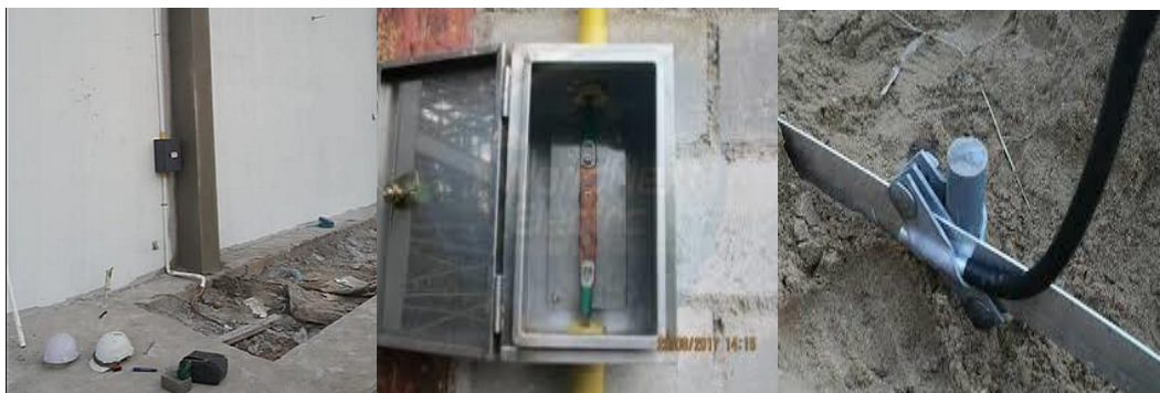
สายนำลงดิน
