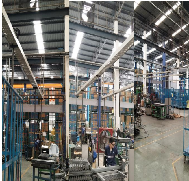
งานติดตั้งระบบไฟฟ้าเครื่องจักรบริษัท เวนซ์ อินดัสเตรียล จำกัด วันที่ 23 -12 -2559
