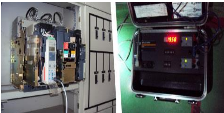
ตรวจเช็คแอมป์เซอร์กิตเบเกอร์ 1250 A.
