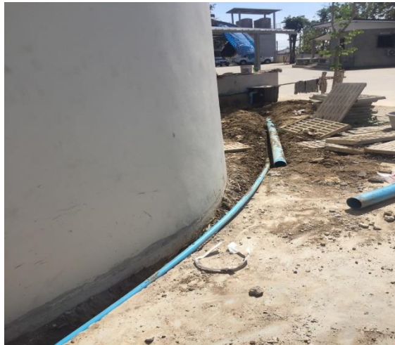
บริษัท เพิ่มเพียร คอนสตรัคชั่น แอนด์ เทรตติ้ง จำกัด ประกอบกิจการติดตั้งระบบประปา
