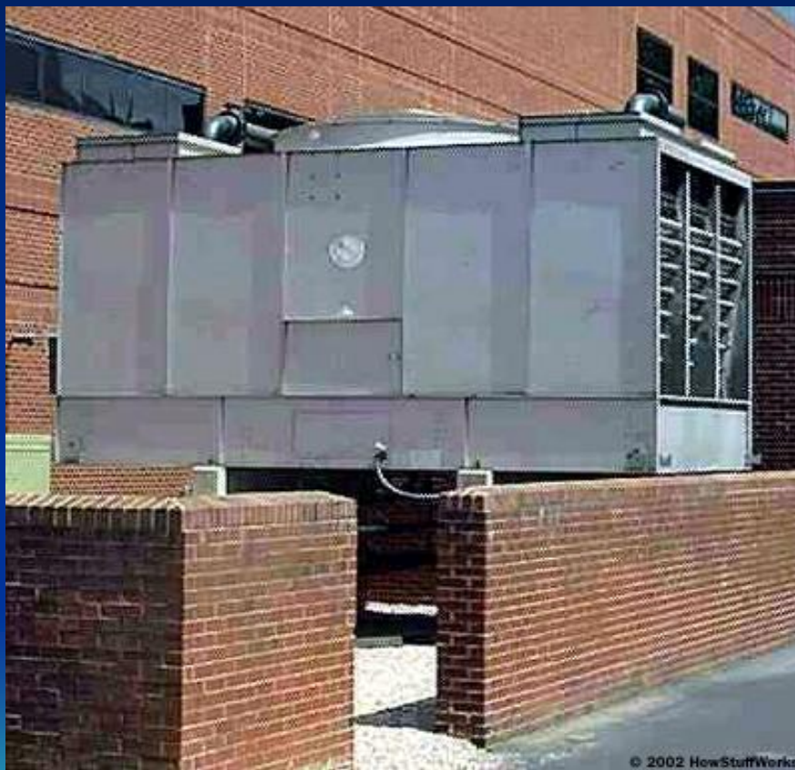
รูปที่ 3.3 หอหล่อเย็น (Cooling Tower)
