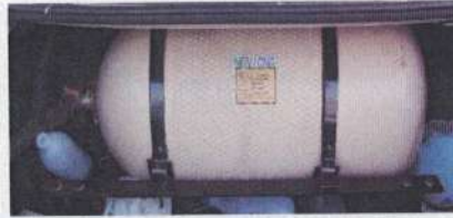
รูปถัง CNG-1
